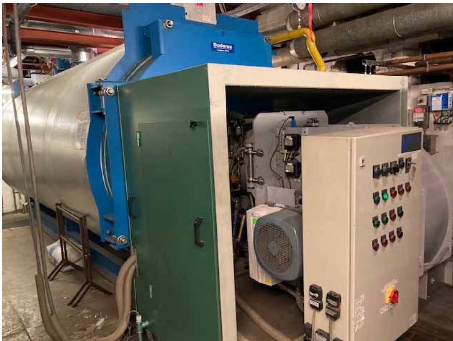
Einer der neuen Kessel im Heizwerk
